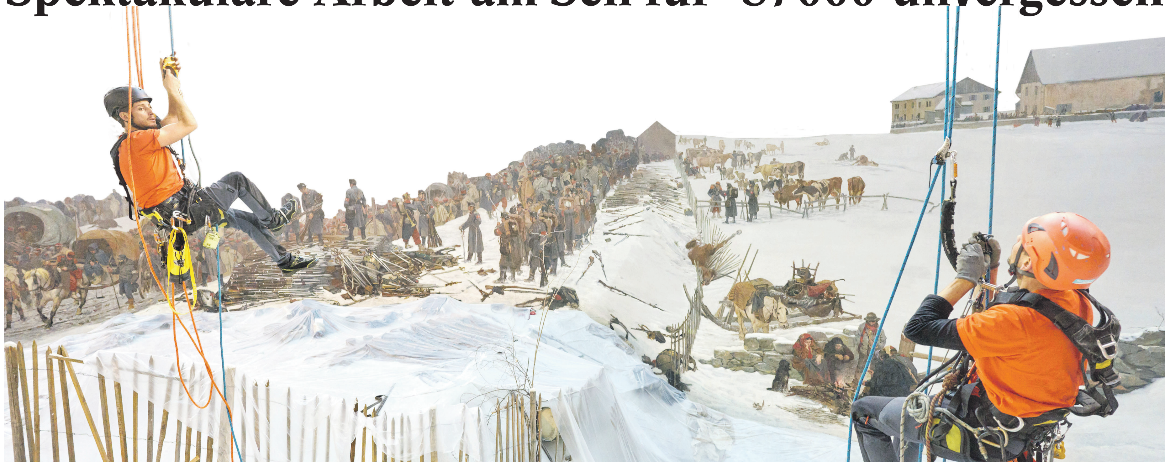
Spektakuläre Arbeit vor eigentümlicher Szenerie: Zwei Industriekletterer der Firma Nordwand Arbeit am Seil GmbH bei Installationsarbeiten – Ersatz Optischer Apparat- vor dem Rundbild Bourbaki Panorama, im Januar 2024.
